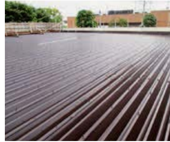
屋根：バイオマス R-Si 神奈川県：スーパーマーケット
