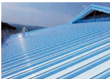
施工中の様子① (左上)吹付作業の様子。屋根の大きさが良くわかる写真
