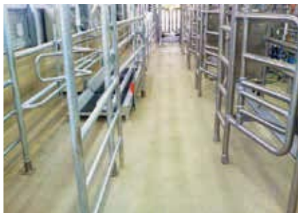
神奈川県：酪農施設 床：ポウジンテックス UコンII 施工：(株)日誠cfc
