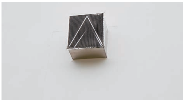
高熱の蒸気を常に排出するためすぐに黒ずんでしまっていたというダクト部分。塗り替えてから2年経過した今でも綺麗なまま保たれている。
