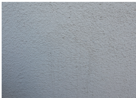
撥水性を発揮していない
