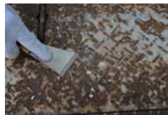
付着強度不良の死膜及びさびが発生している箇所は、皮スキヤワイヤーブラシ等で除去する。
