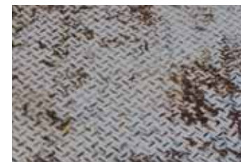
死膜、さびの除去を行わないまま塗装すると、はがれの原因となります。
