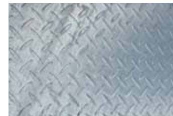
通常のさび止めプライマーでは付着せず、はがれの原因となります。
