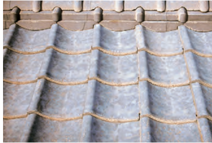
旧塗膜が風化し、はがれている。 基材の風化も始まっている。
