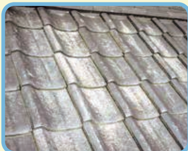
旧塗膜が残っているが色あせ、汚れがある
