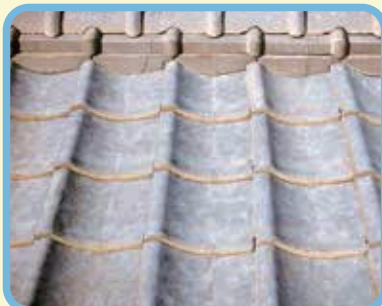
旧塗膜が風化し、はがれている。 基材の風化も始まっている。
